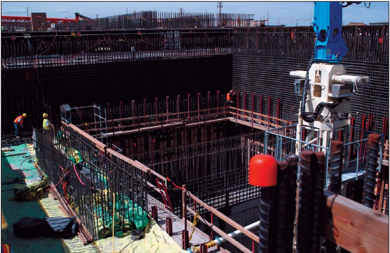
廃棄物処理プラントで容器ピットの壁型枠を施工する作業員。このピットにタンク廃棄物を受け入れることになる。主請負業者である BNI 社を支援する業務には、技術審査とプロセス検証の指導が含まれる（写真は BNI 社の厚意による）。
